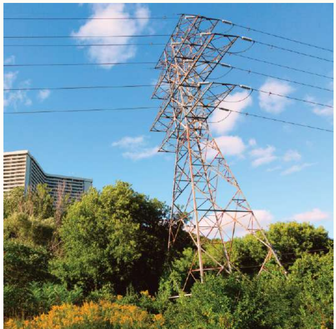
Figura 1. Torres de Transmisión Eléctrica
